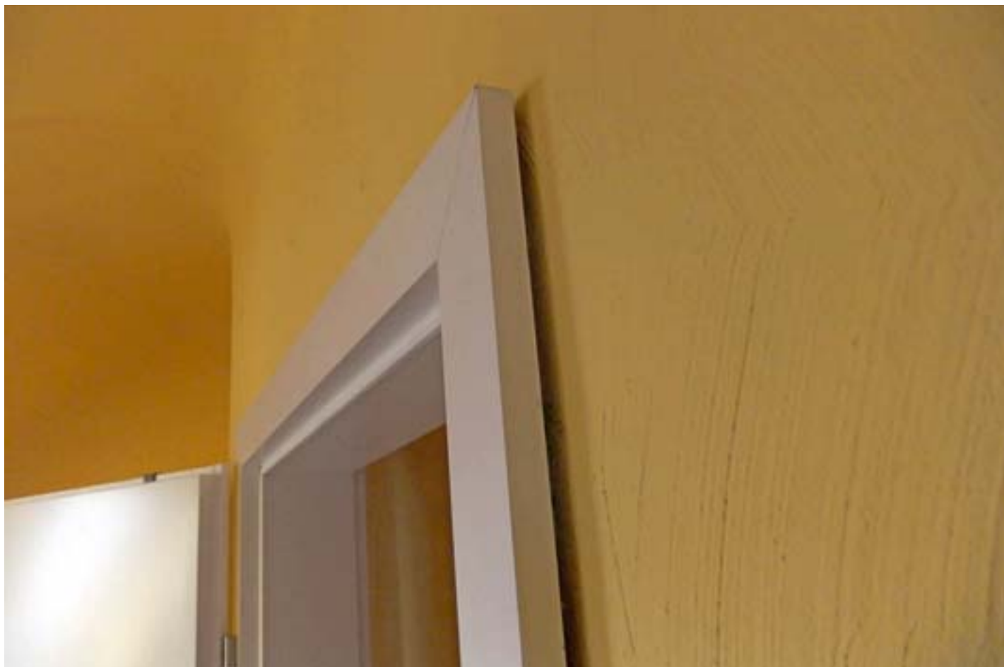
/ Offene Fugen: Die Wand wurde im Rahmen der DIN 18202 regelkonform hergestellt, das Türelement lotrecht montiert. Und jetzt?
